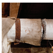
aislantes de tuberías
